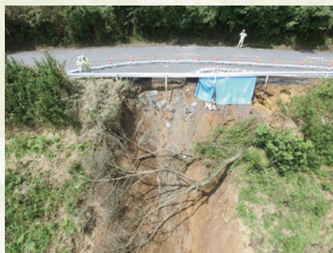
一般県道つくば公園永井線被災状況(石岡市小幡地内)
