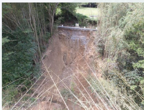
H28年台風9号被災状況調査(県道石岡つくば線)
